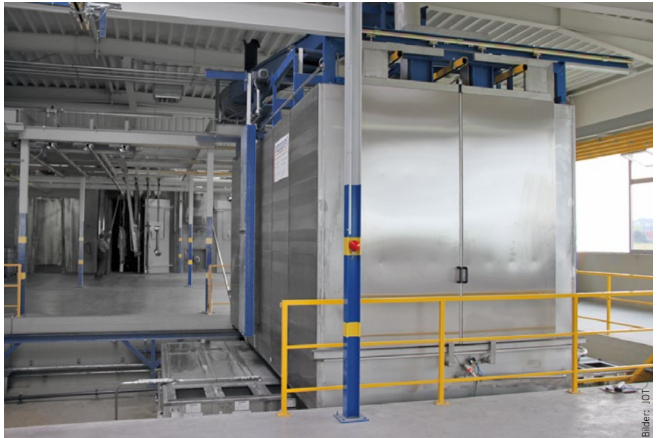
Die Teile werden über Traversen in einer geschlossenen Anlage über die einzelnen Becken gefahren. Die verkleinerten Becken benötigen weniger Energie zur Beheizung und sparen so Kosten.
