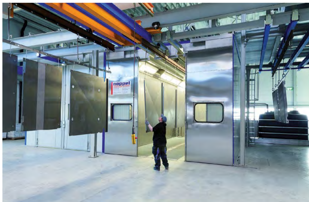
In der Reinigungs- und Vorbehandlungskabine erfolgen die wässrige, nass-chemische Reinigung und Korrosionsschutz-Vorbehandlung. Quelle: Noppel
