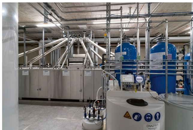
Behälter-Einheit mit 5 Aktiv- und 6 Spülbecken für die Multi-Metall-Vorbehandlungsanlage.
