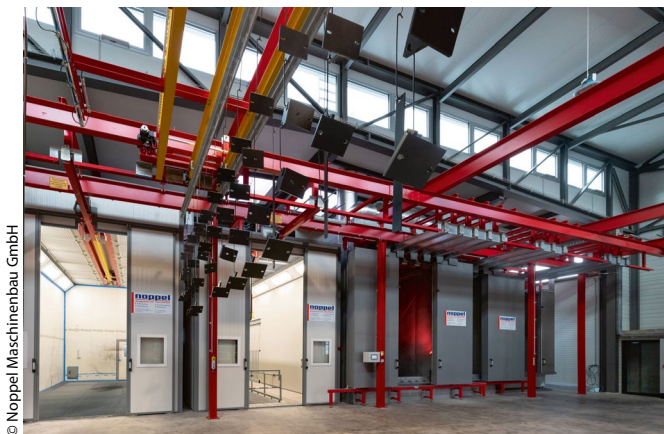
Anlagen-Ansicht mit Lackierkabine, Pulverkabine, Pulvereinbrennofen, Haftwassertrockner und Vorbehandlungsanlage.
