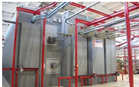
Haftwasser und Einbrennofen sind in energieeffizienter Blockbauweise ausgeführt.
